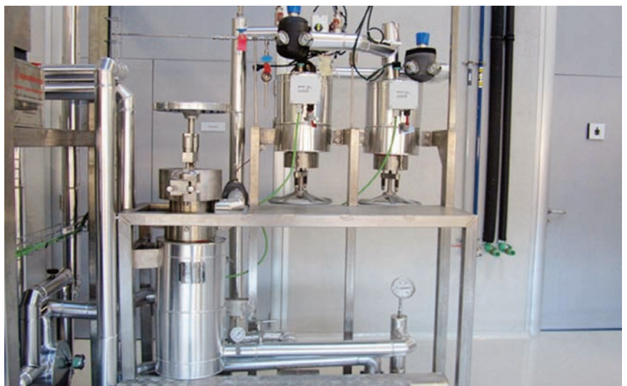
Detalle de extractor y depósitos de descompresión
