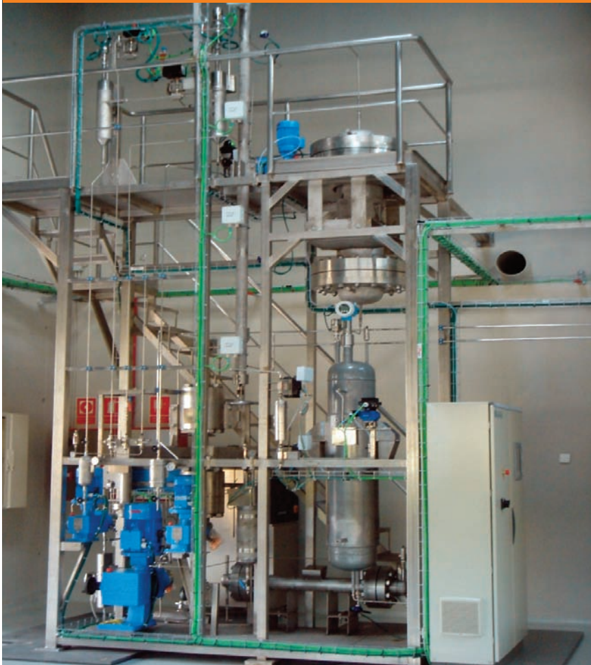
Planta completa de extracción de productos líquidos
