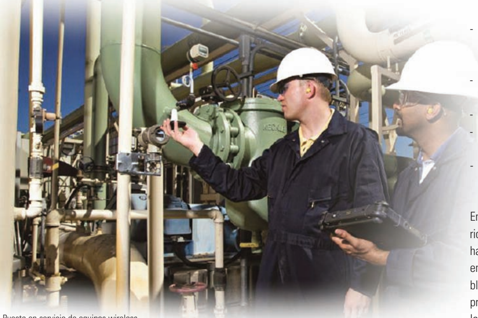
Puesta en servicio de equipos wireless.
