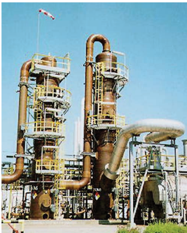
Figura 4. Lavador de gases de combustión (Izquierda: columna de neutralización después del absorbedor de HCl). Los gases conteniendo HCl y Cl 2 , lavados con NaOH/NaOCl a pH 9 y T=65 °C. Resina epoxi vinilester de Bisfenol A, curada con BPO. Renovación local de la barrera CR después de 5 años de servicio como consecuencia de hipoclorito inestable (14)
