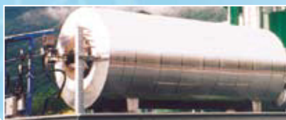
Oxidación térmica recuperativa
