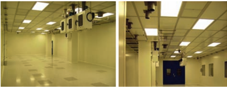
A través del suelo, que está agujereado, se succiona el aire llevándose hasta un sótano donde se sitúa un impulsor que lo vuelve a filtrar y lo envía de nuevo al filtro situado en el techo de la sala.
