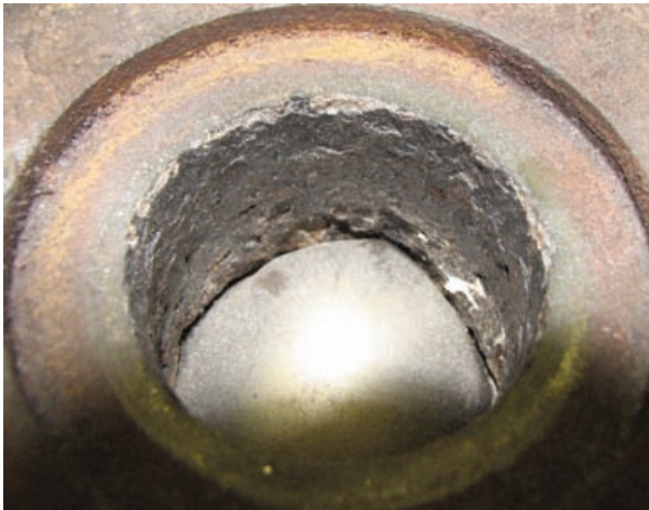
Figura 2: Aspecto de un disco de ruptura bajo los efectos de una importante corrosión.
