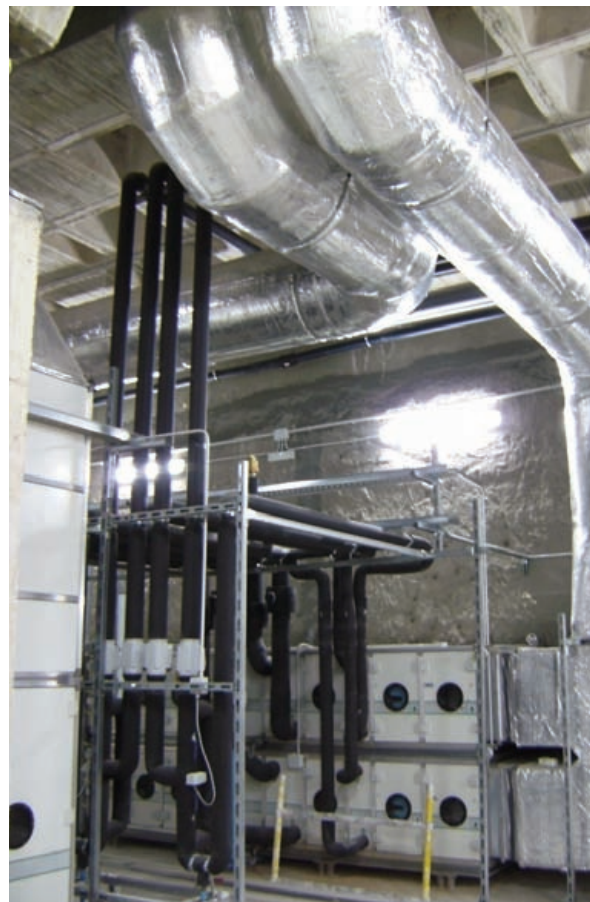
Se trata de la única sala limpia clase 10 en España aplicada al campo de las nanotecnologías.
