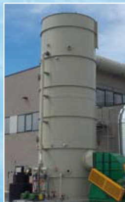
Torre de lavado
