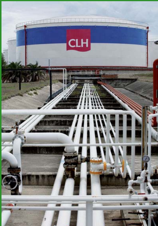
Instalaciones CLH en España.
