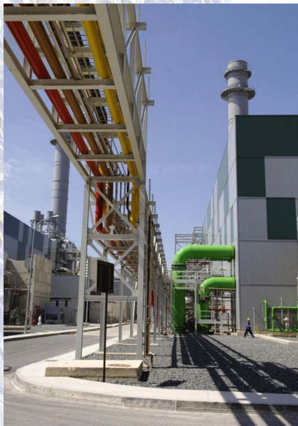
Central de ciclo combinado de Gas Natural en La Plana del Vent (Tarragona).
