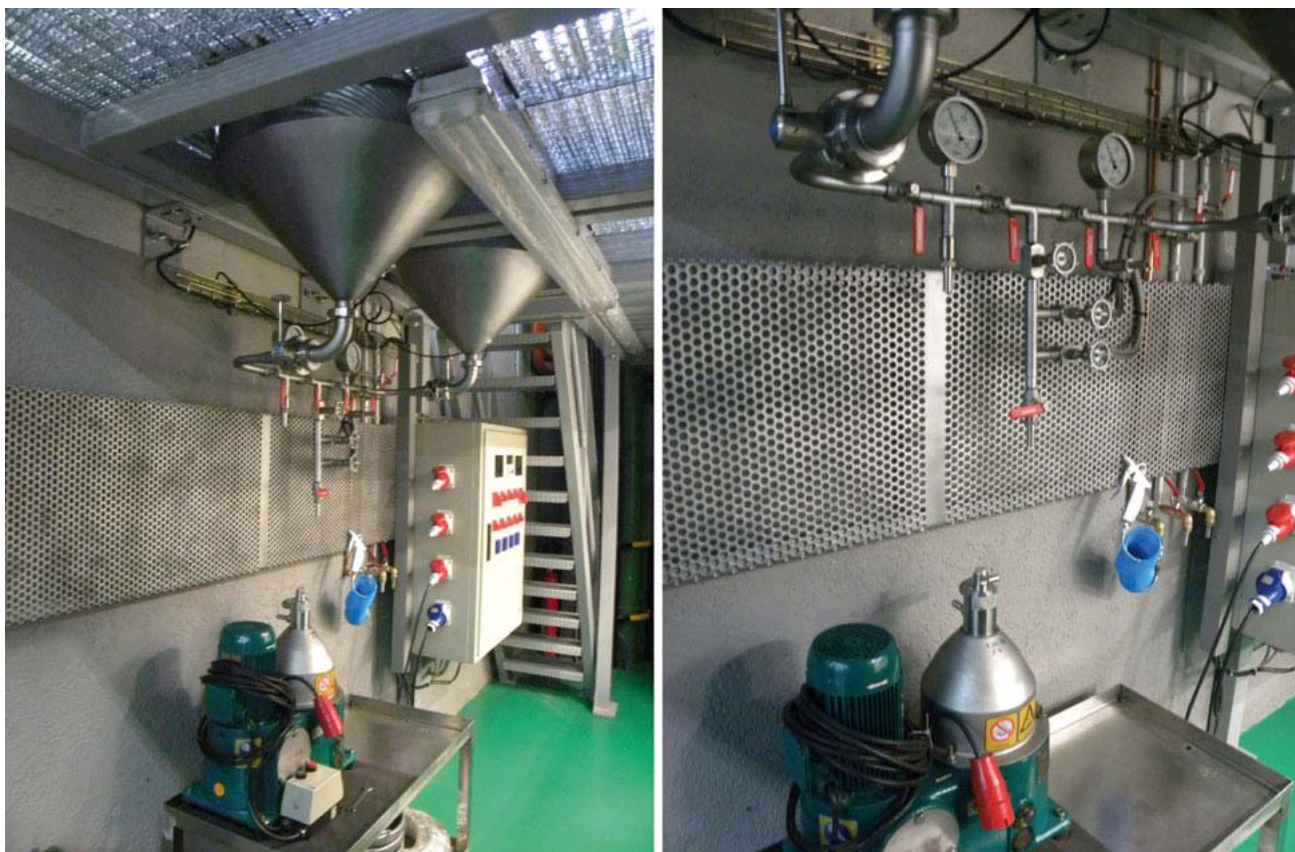
Departamento de aplicaciones o pruebas de Gea Westfalia Ibérica en su sede de Granollers (Barcelona).
