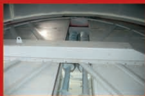
Extractores mecánicos e hidráulico
