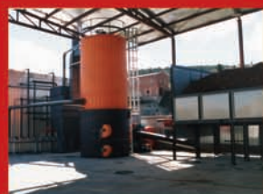
Calderas de biomasa con alimentación automática
