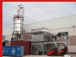
Baterías de filtros
