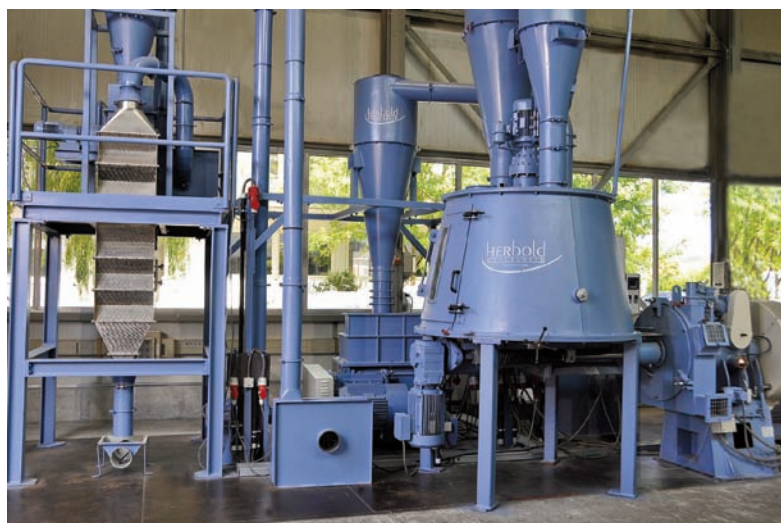
Instalación Plast-Compactor Herbold modelo HV 50.
