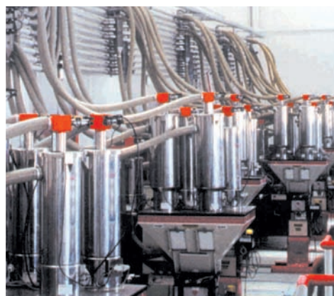
Instalación de transporte
