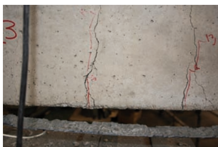
Rotura por despegue y curvas cortante-flecha de vigas reforzadas a flexión
