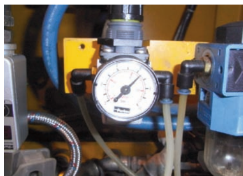
Detalle de un sistema de aire comprimido donde se muestra la presión de trabajo.
