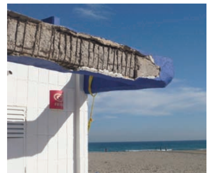
Ejemplo de corrosión de la armadura.
