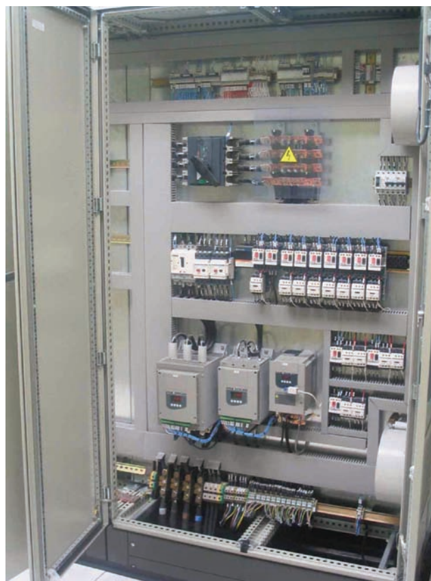
Armario de mando central dotado de un PLC de última generación.
