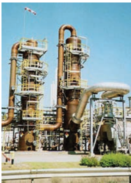
Figura 4. Lavador de gases de combustión (Izquierda: columna de neutralización después del absorbente de HCl). Los gases conteniendo HCl y Cl 2 , lavados con NaOH/NaOCl a pH 9 y T=65 °C. Resina epoxi vinilester de Bisfenol A, curada con BPO. Renovación local de la barrera CR después de 5 años de servicio como consecuencia de hipoclorito inestable (14).
