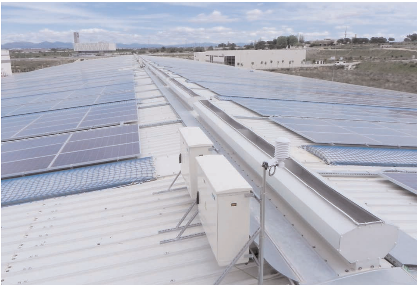
La cubierta de la nave 8 cuenta con 3.891 módulos y una superficie de captación solar total de 7.730 m 2 .
