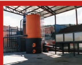
Calderas de biomasa con alimentación automática
