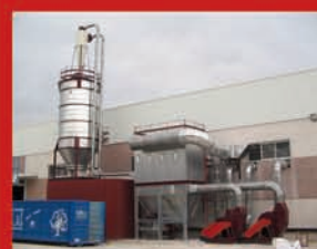
Baterías de filtros
