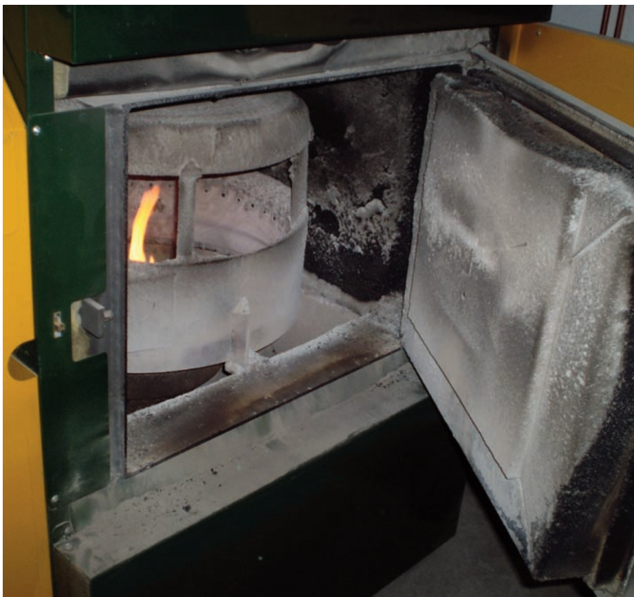
La caldera de biomasa de la escuela de Tabuyo del Monte.
