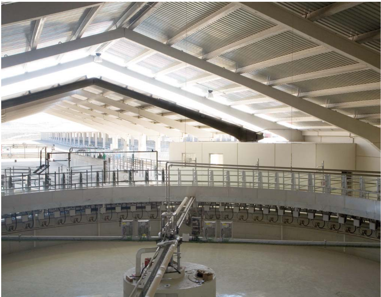
Vista de la sala de ordeño de Gea Farm Technologies instalada en la sociedad Valle de Odieta.
