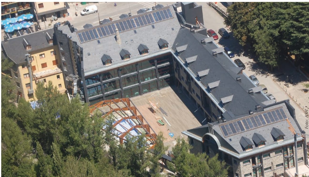
Instalación de 120,80 m 2 en el Hotel Aneto de Benasque (Huesca), realizada por Tisun.
