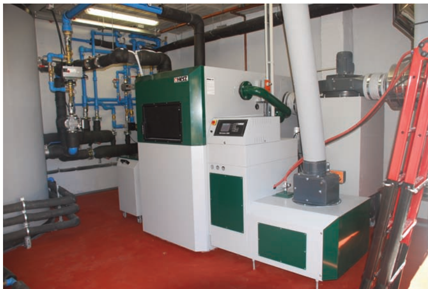
Caldera instalada en la escuela Salvador Vinyals del municipio.
