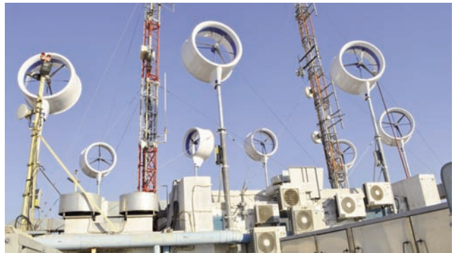
Detalle de la instalación de 8 miniaerogeneradores en la azotea del centro comercial Amoreiras, en Lisboa.
