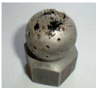
Ilustración 18. Corrosión química de una bola de pulverización
