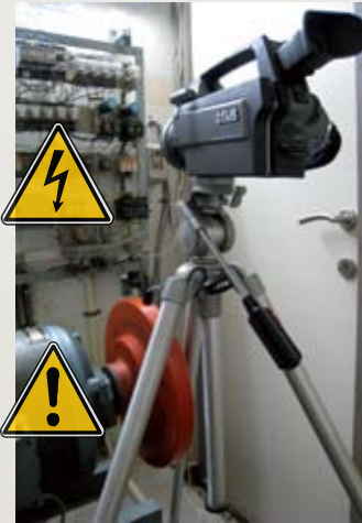
Peligro de electrocución y de rueda mecánica rotatoria.
