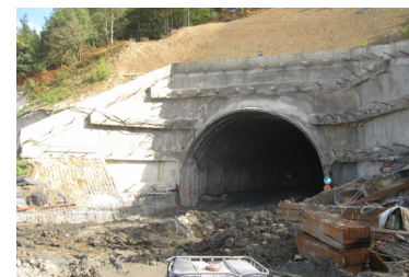
Perforación en galería, saneamiento de techos, hastiales y paramentos, nivelación de suelos
