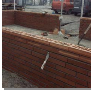
Detalle de las llagas verticales sin mortero.
