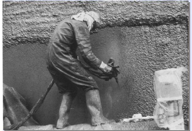
Aplicación de los años 70 de una capa de espuma de poliuretano a un depósito de almacenamiento de petróleo, para que actúe como aislante.
