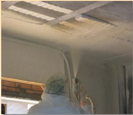
El poliuretano proyectado en el techo puede compensar pequeños desperfectos en las bovedillas
