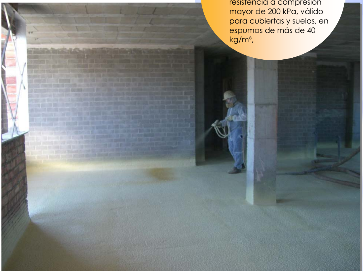
Proyección de poliuretano con una resistencia a compresión mayor de 200 kPa en el suelo de la planta baja.
