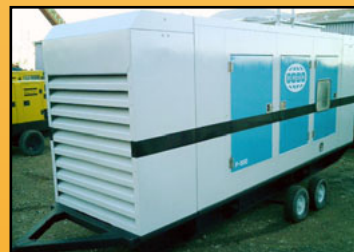
GRUPO ELECTRÓGENO WILSON 330KVA
